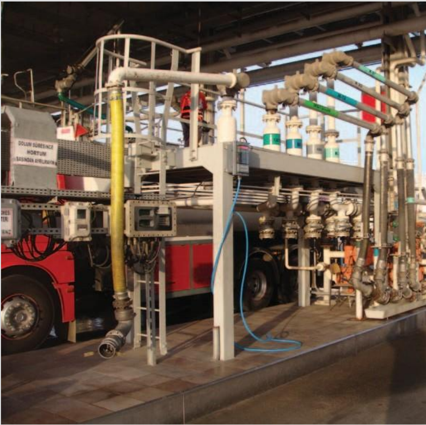
Chargement et déchargement de camion-citerne
